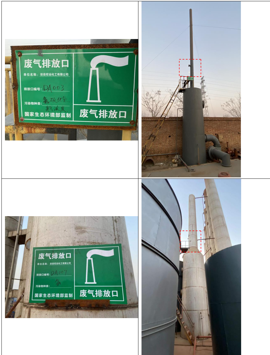
图 4-8 废气排污口标志及检测采样孔
